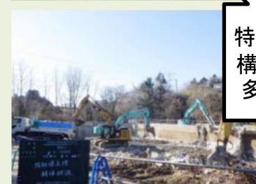
下水処理場 事務所・処理槽等含む
